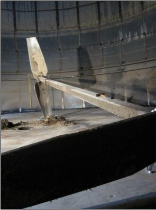
Den primære rådnetanks centralomrører
