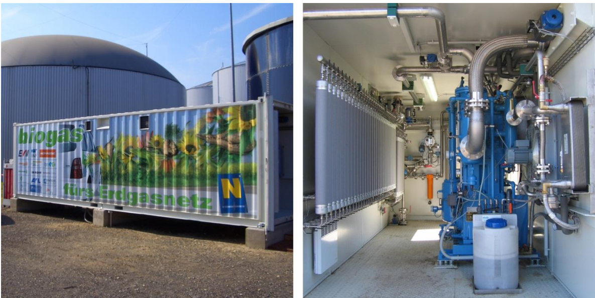
Visning ude- og indefra af biogas opgraderingsanlægget Bruck / Leitha, som viser kompressor, varmevekslere (til højre) og membranmoduler (til venstre)
