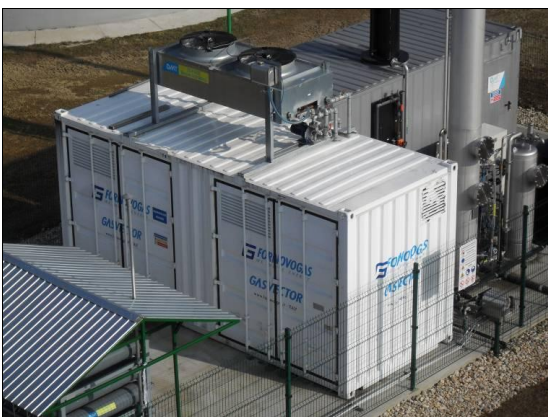
Biogas opgraderingsenhed i ISO stål container
