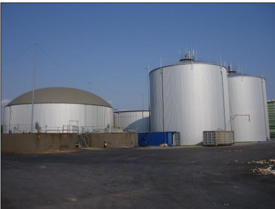
De 2 primære rustfrie stål rådnetanke (til højre) & den sekundære rådnetank med gaslager (bagerst til venstre)
