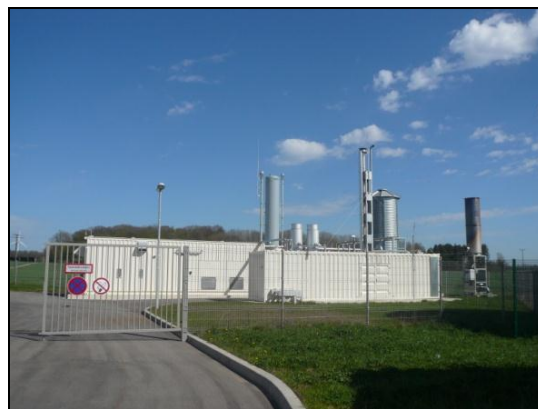
Oversigtsbillede over biogas opgraderingsanlægget bestilt i 2010
